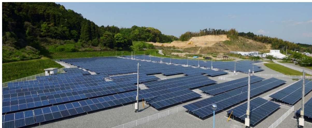
基山太陽光発電所
